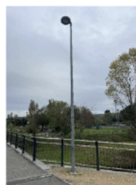
FAROLA TIPO 1 "PUENTE" 3 UDS.
